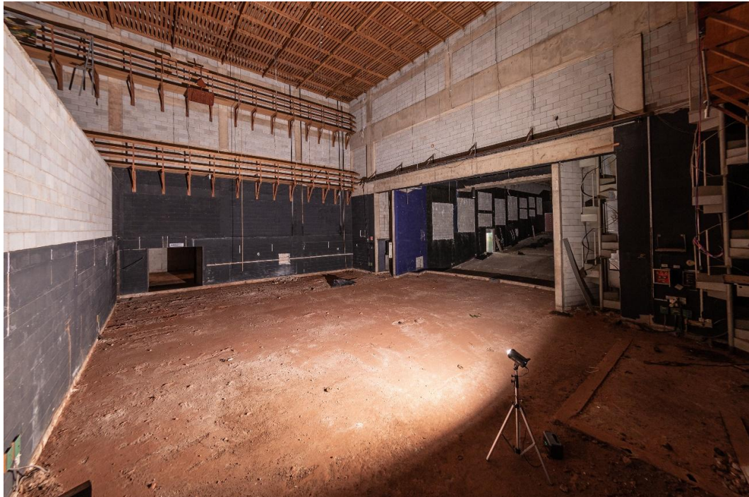
Figura 15 – Vista Interna Lateral Direita do Acesso ao Almoxarifado, Acesso ao Palco e Escada Helicoidal de acesso ao Mezanino do Palco
