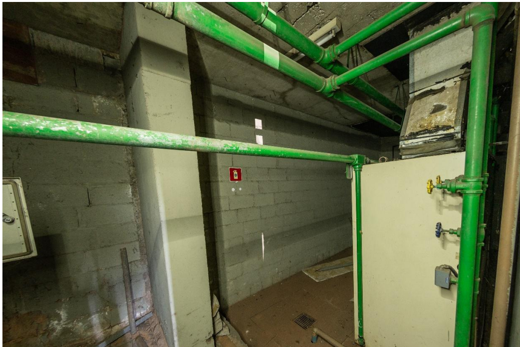
Figura 26 – Casa de máquinas
