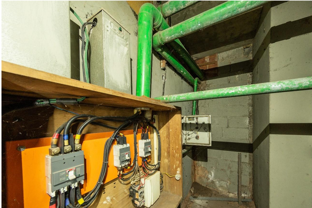
Figura 25 – Casa de máquinas
